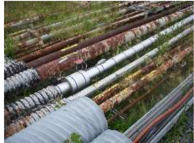
Canalisations non identifiées et en mauvais état
