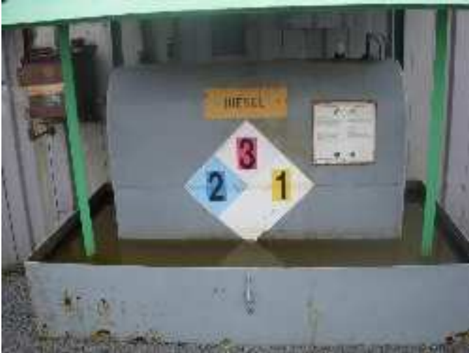
Bassin de rétention inapproprié
